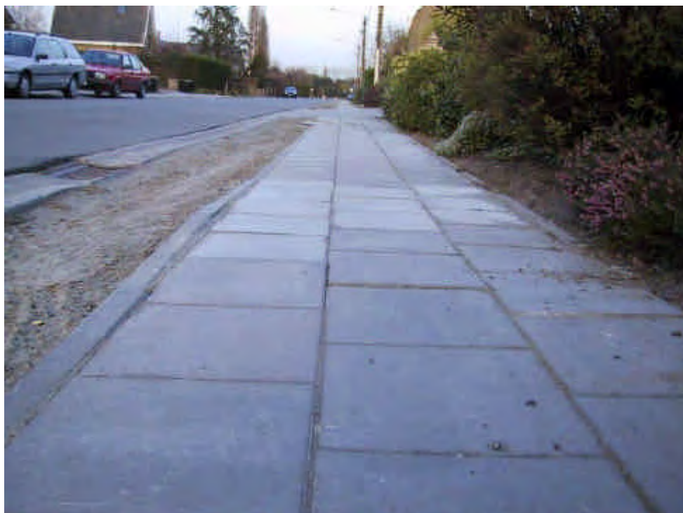
Gebrekkige herstelling van het splinternieuwe voetpad
