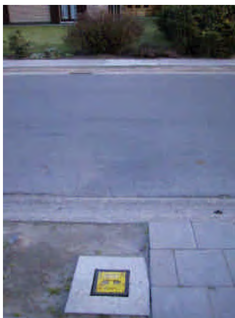
Het gaat hem wel degelijk over verzakking ter hoogte van de uitgevoerde werken in opdracht van VEM (zie gas-aansluitpunt en slecht hersteld voetpad aan de overzijde van de weg)
